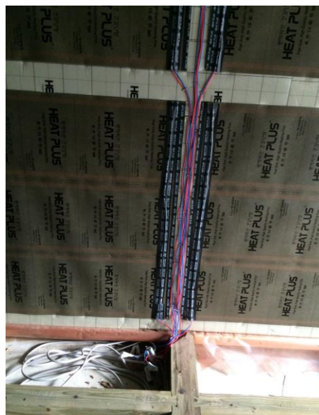
【壁面 配線部分】
